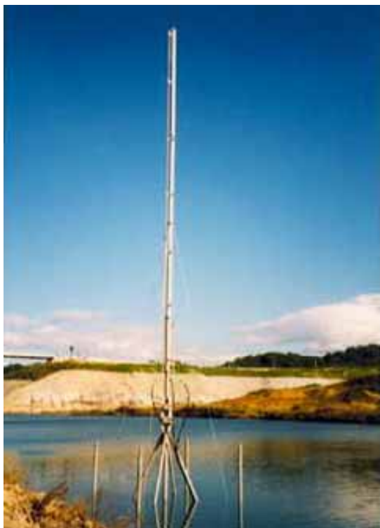
浅層曝気施設の外観
