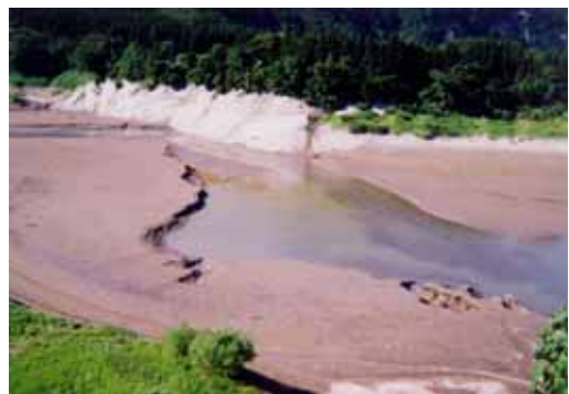
D ダム流入端堆砂状況
